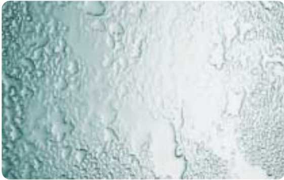
Deutliche Spuren von zu hoher Feuchtigkeit: Kondenswasser am Badezimmerfenster
